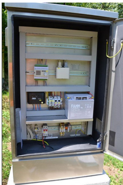
Slika 6: Avtomatska merilna postaja za površinske vode s priklopom na solarno napajanje, tip komunikacije GSM/GPRS
