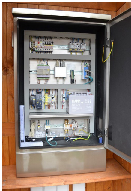
Slika 5: Avtomatska merilna postaja za površinske vode s priklopom na javno elektro omrežje, tip komunikacije ADSL/MPLS
